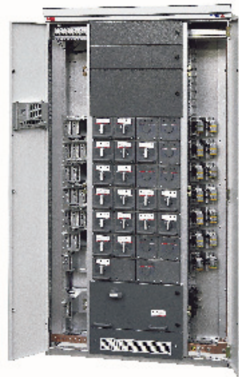
Armoire de départs-moteurs
